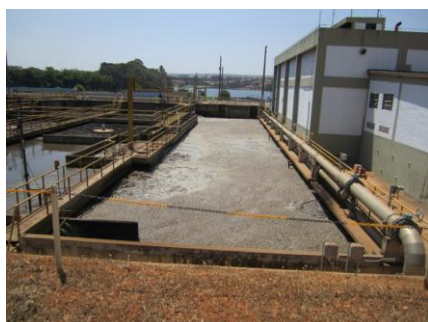
④下水処理施設の曝気槽（ブラジル）
